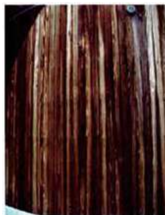
写真1 木製外壁の灰色化 右側は日当たりや雨降りが多く灰色化している。左側、灰色化した後でも両側の色やデザインとマッチするよう設計すれば、灰色化の悪影響を軽減することも可能である。
